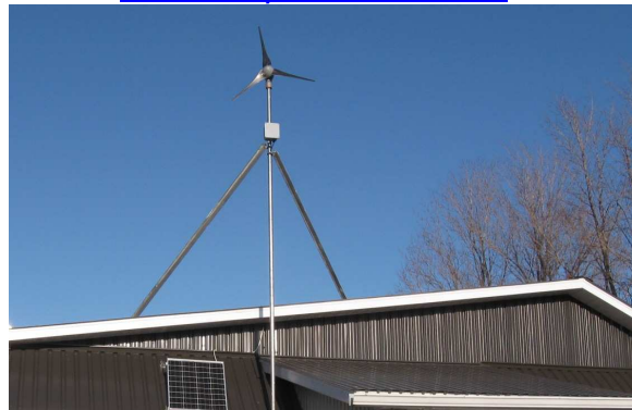
Éolienne et solaire
