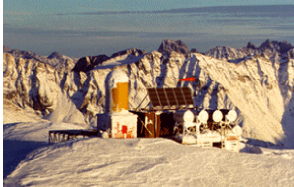
Station de relais de télécommunication alimentée par un système photovoltaïque hybride et installée au Parc national Nahanni, Territoires du Nord-Ouest), Canada (62° N) [photo:Northwest Tel Inc.]
